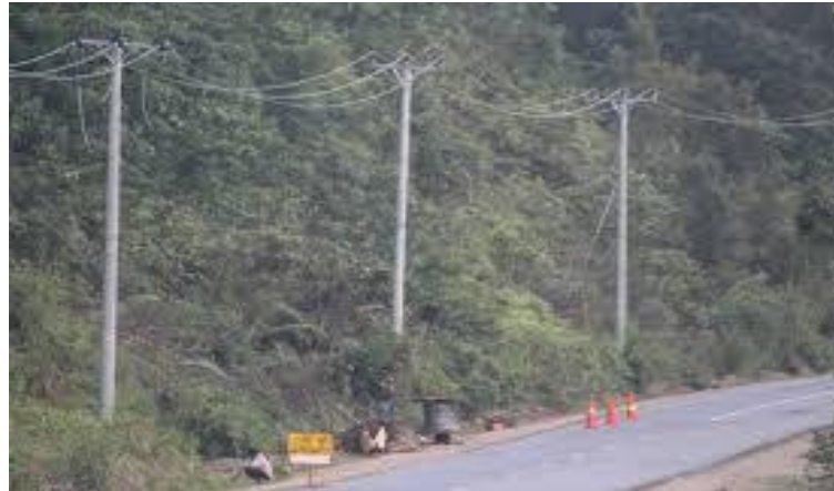
Gambar 2.8. Saluran Udara Tegangan Menengah
