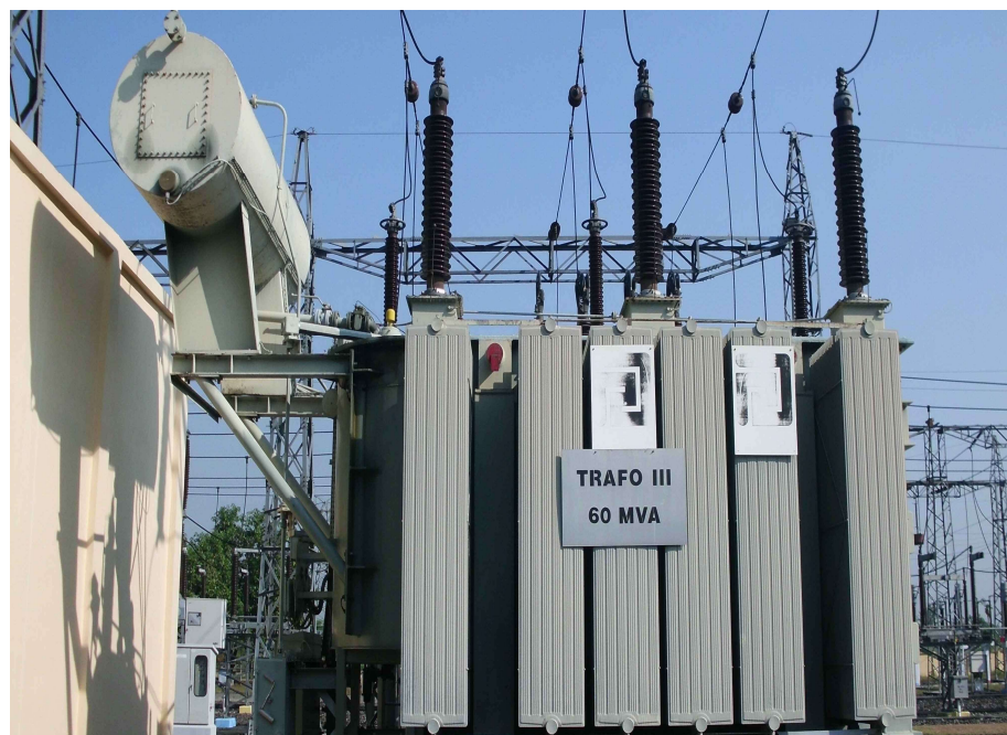
Gambar 2.6. Transformator Gardu Induk
