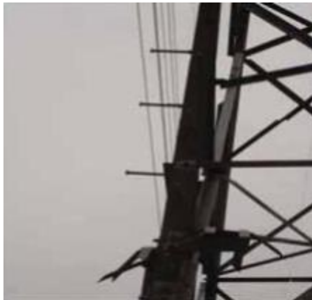
Gambar 2.18. Step bolt pada Tower
