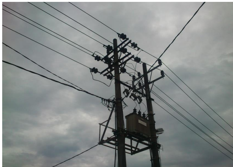
Gambar 2.5. Saluran udara tegangan menengah
