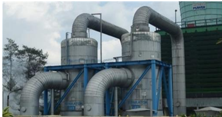
Gambar 2.4 Separator Unit 2 dan Unit 3
