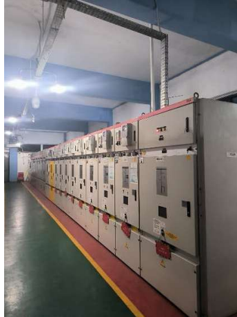
Gambar 2.8 Penyulang 20 kV di GIS Durentiga ( Sumber : Dokumentasi Pribadi )
