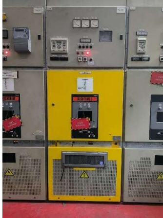
Gambar 2.9 Kubikel Incoming 20 kV di GIS Durentiga ( Sumber : Dokumentasi Pribadi )
