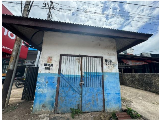
Gambar 2.7 Gardu Beton (Sumber: PLN UP3 Merauke 2024)
