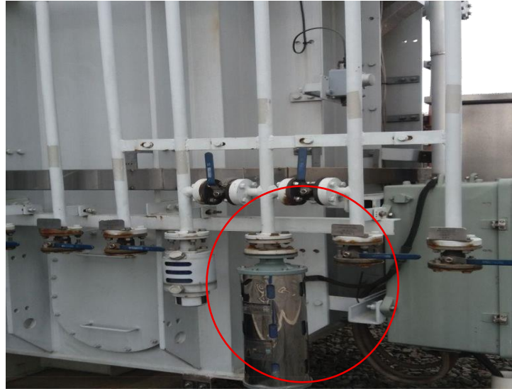
Gambar 2.8 Air Breather pada transformator Daya
