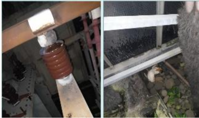
Gambar 1. 4 Flash pada PI 20 kV akibat kucing Trf #2 GI Batang
