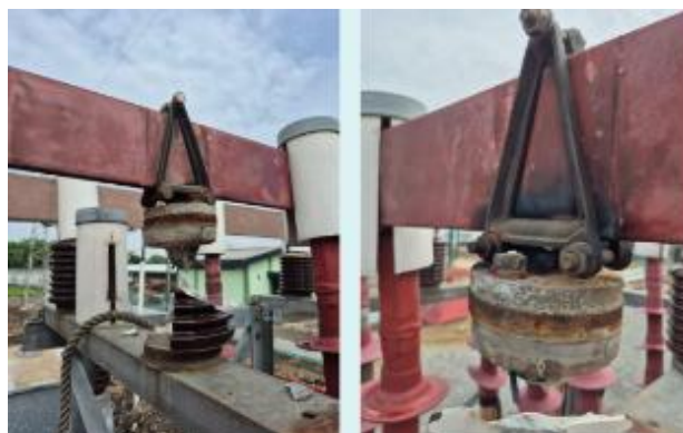
Gambar 1. 3 PI 20 kV pecah akibat kegagalan isolasi di Trf #8 GI Kosambi Baru
