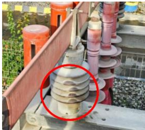
Gambar 1. 2 Flash pada PI 20kV Trf #3 GI Semen Baru akibat polutan tinggi
