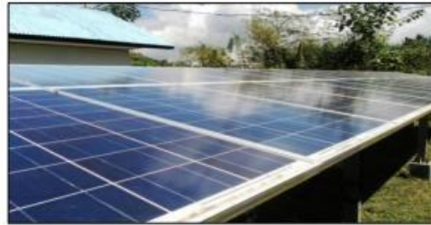
Gambar 2. 1 Pembangkit Listrik Tenaga Surya[1]
