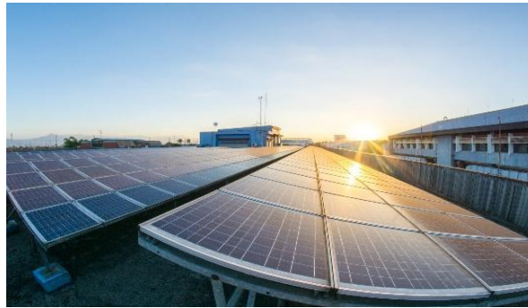
Gambar 2. 2 Pembangkit Listrik Tenaga Surya (Sumber: esdm.go.id)
