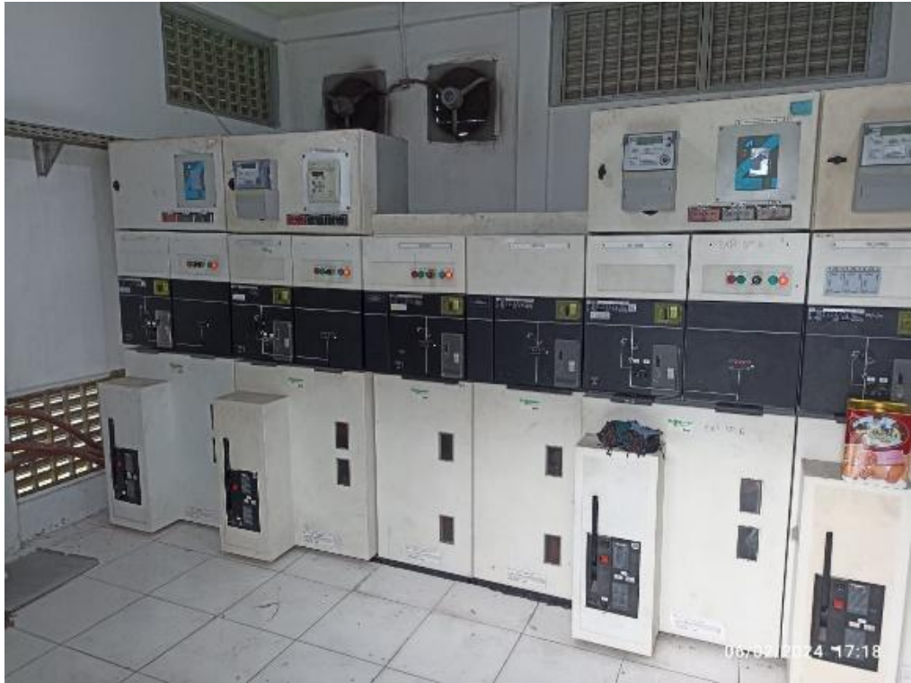
Gambar 2. 6 Tampak Dalam Gardu Hubung
