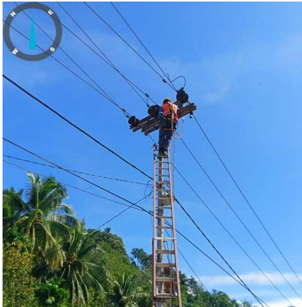
Gambar 2. 2 : Jaringan tegangan Menengah Sumber: Dokumentasi Pribadi
