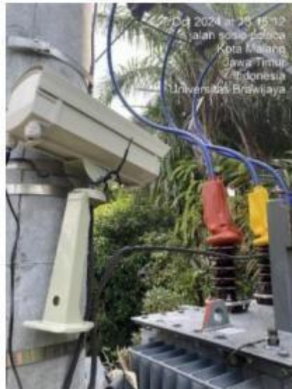
Gambar 2. 15 Pemasangan Alat Monitoring Pada Trafo 20KV -380V
