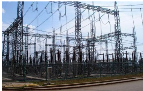
Gambar 2. 3 Busbar gardu Induk Transmisi
