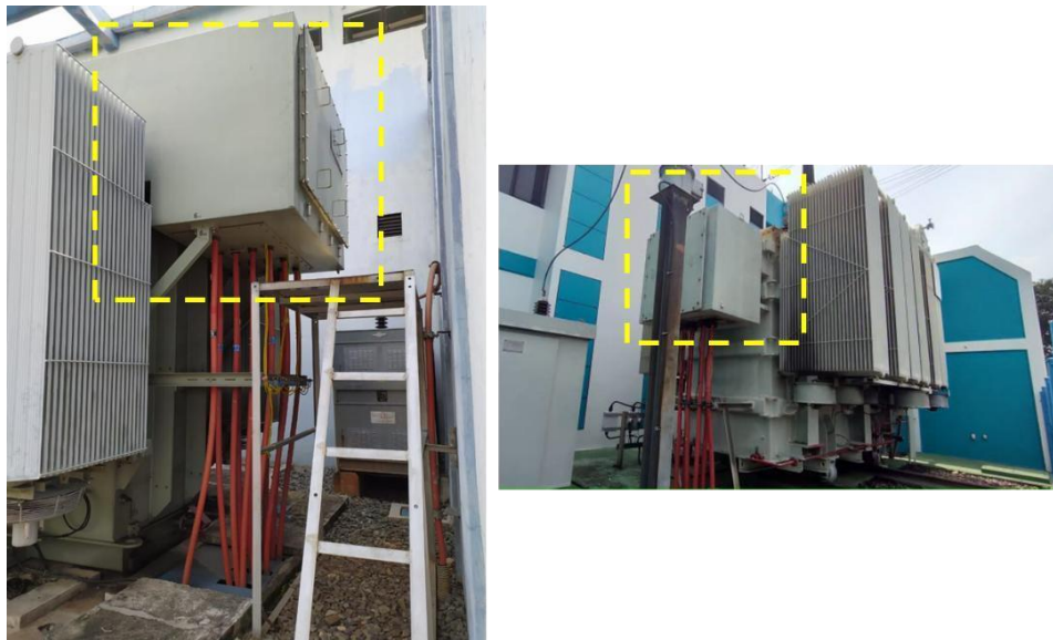
Gambar 2. 10 Trafo daya dengan desain busbar LV
