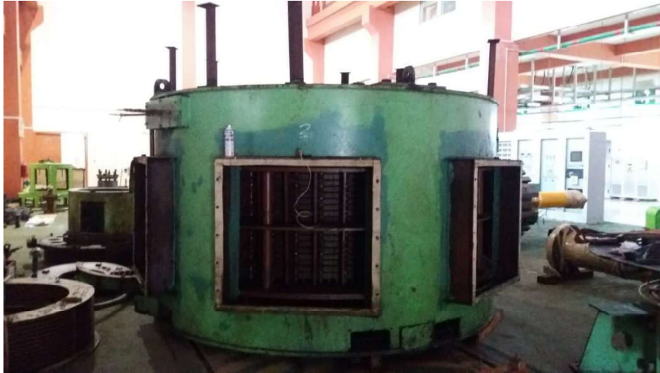
Gambar 2.2 Stator Generator Unit #1 PLTA Orya Genyem (Dokumentasi Pribadi, Maret 2025)
