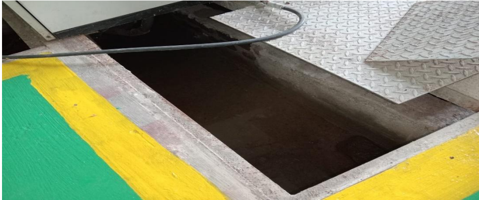
Gambar 2. 6 Manhole kubikel terdapat genangan air
