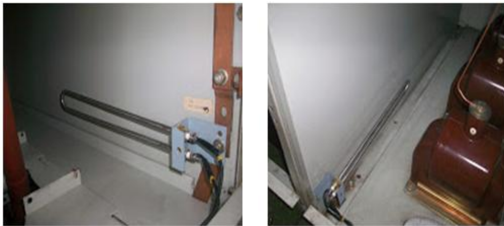
Gambar 2. 3 Heater pada Kubikel
