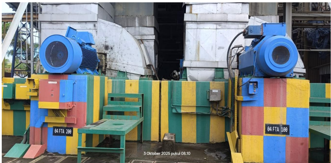
Gambar 2. 1 Motor Listrik 6 KV PLTU UP Bukit Asam
