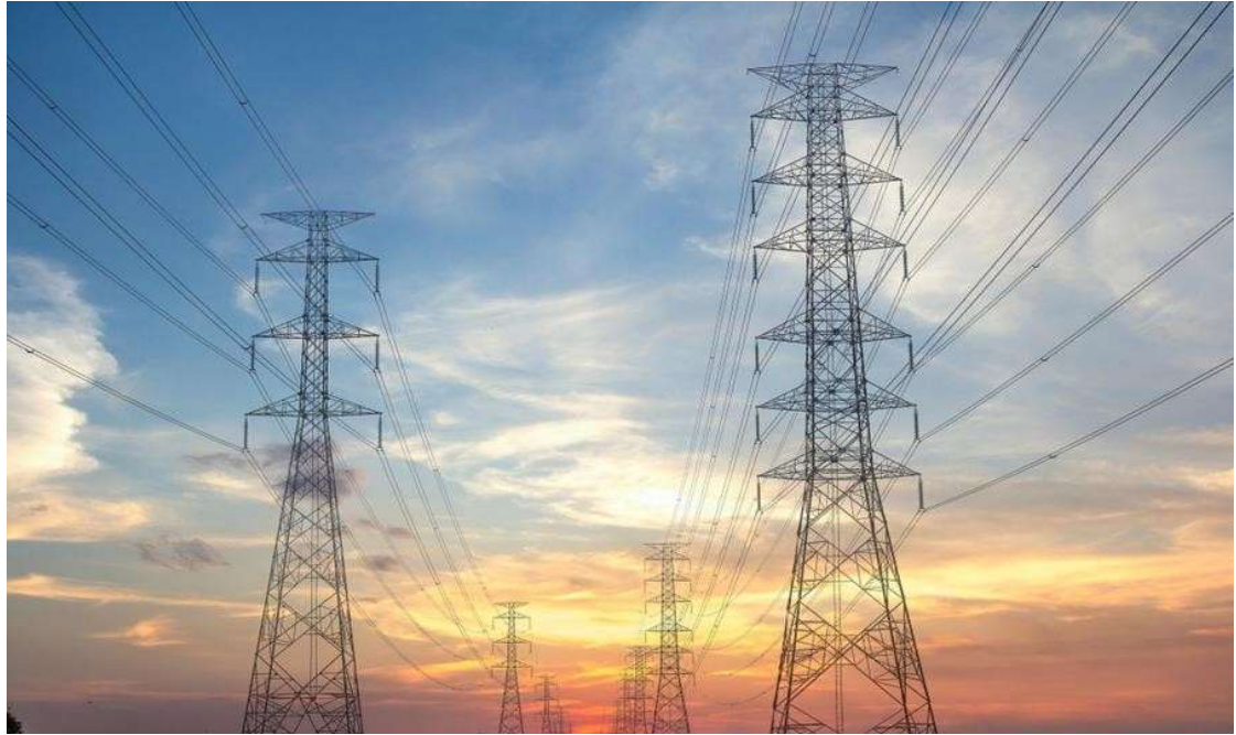
Gambar 2. 3 Saluran Transmisi Tegangan Tinggi
