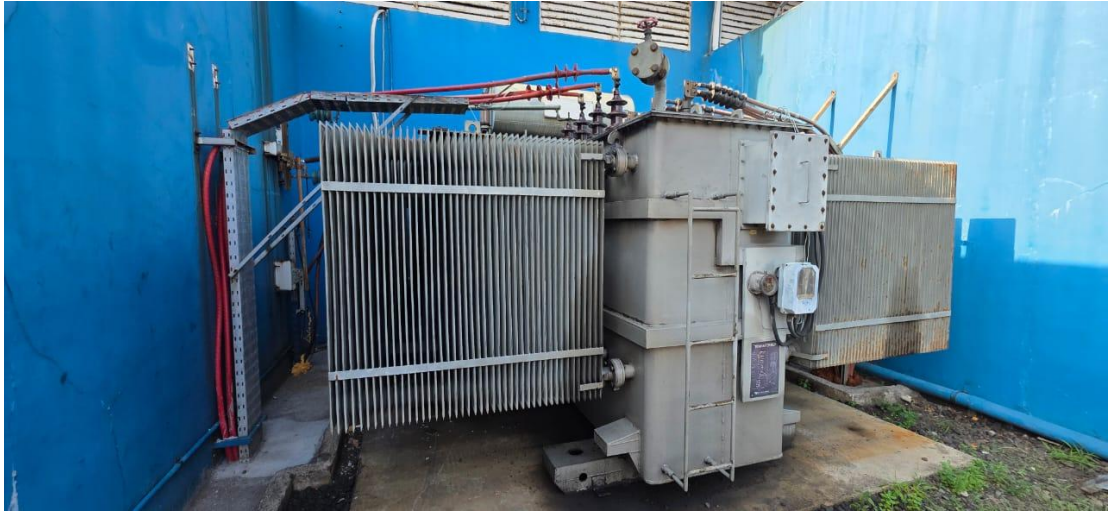
Gambar 2. 2 Transformator 10 MVA 20/6,3 kV PLTD)
