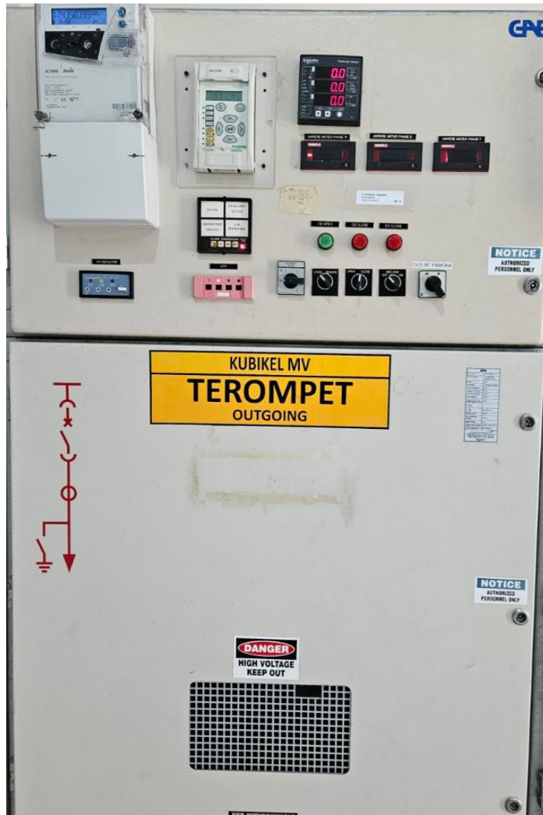
Gambar 2. 5 Kubikel 20 KV Beserta Komponennya Sumber : dokumentasi pribadi
