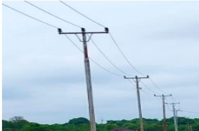
Gambar 2. 1 jaringan Distribusi Kabel Udara
