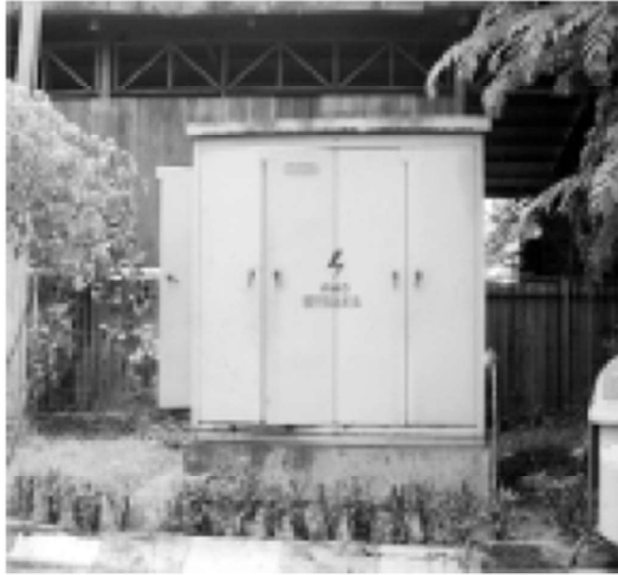
Gambar 2. 3 Gardu Kios, sumber (Buku 4 PLN, 2010)
