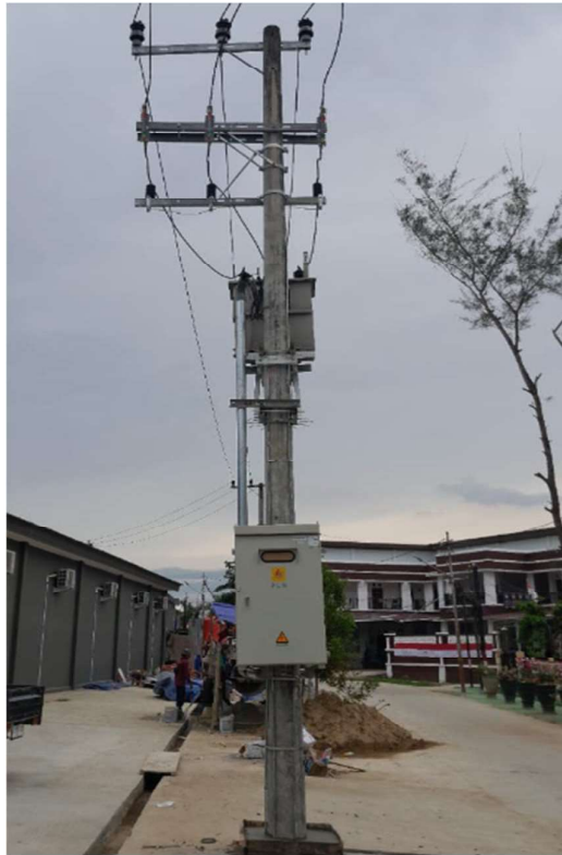
Gambar 2.5 Gardu Cantol, sumber (Dokumentasi Pribadi)
