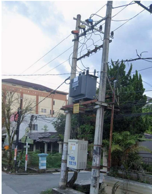
Gambar 2.4 Gardu Portal, sumber (Dokumentasi Pribadi)
