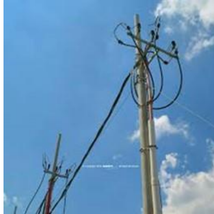
Gambar 2. 3 Saluran Kabel Udara Tegangan Menengah
