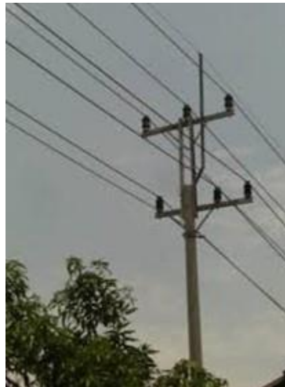
Gambar 2. 2 Saluran Udara Tegangan Menengah
