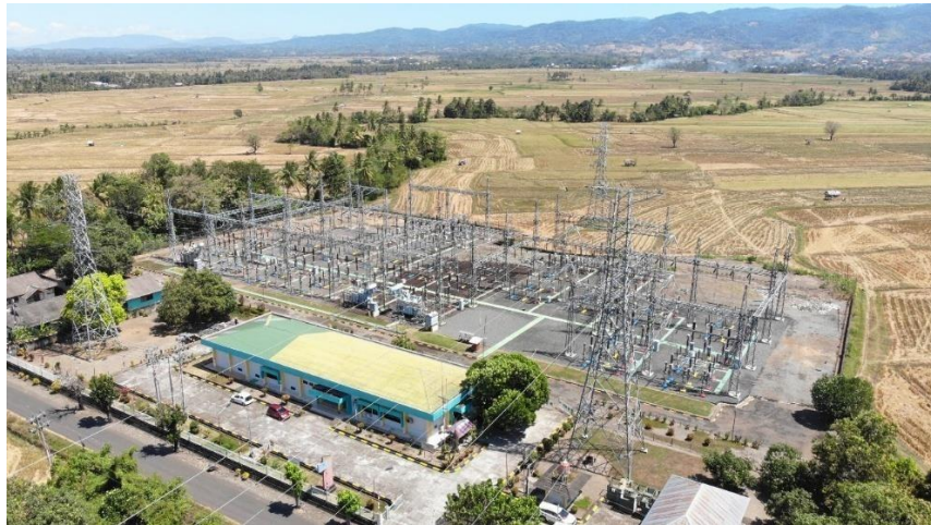
Gambar 2. 1 Gardu Induk Soppeng 150 kV
