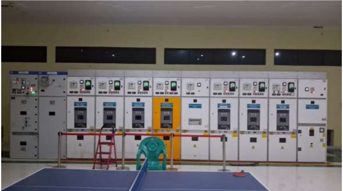
Gambar 2. 3 Kubikel 20kV GI Kolaka
