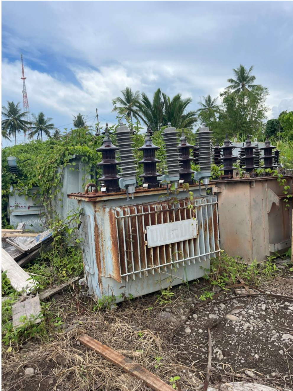
Gambar 2.25 Trafo Step Down
