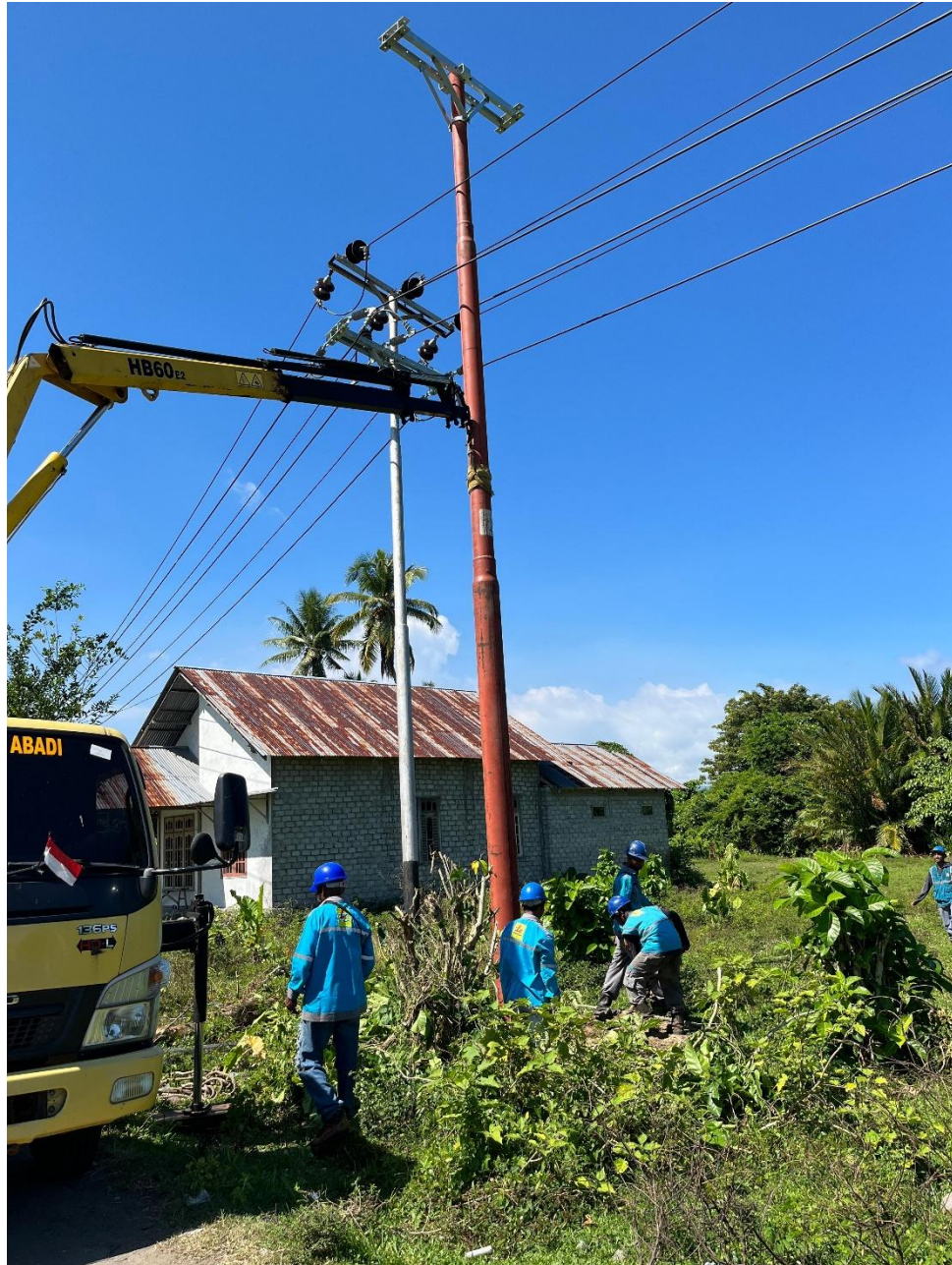
Gambar 2.10 Tiang Listrik milik PLN
