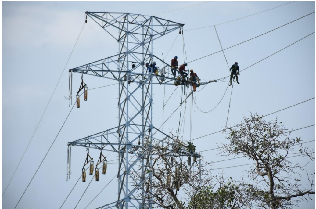
Gambar 2.16 Tiang Jaringan Transmisi Tegangan Tinggi
