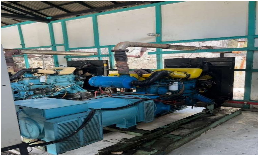
Gambar 2.1 Mesin Diesel sebagai Pembangkit Listrik (PLTD)
