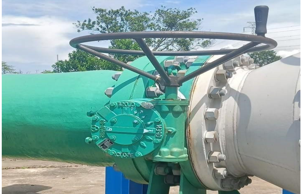
Gambar 2. 27 Inlet dan outlet valve
