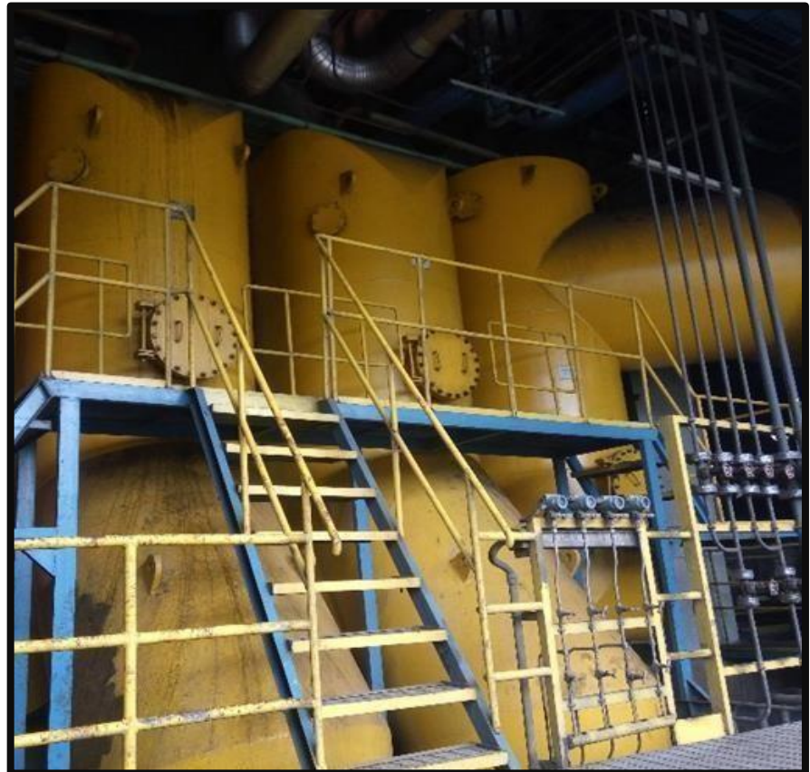
Gambar 2. 6 Kondensor (sumber PLTU Banten 3 Lontar, tahun 2025)
