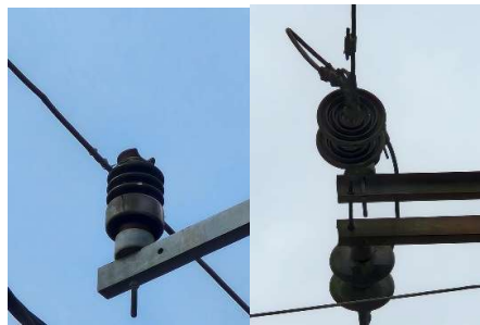
Gambar 2. 8 Pin isolator dan Hang Isolator
