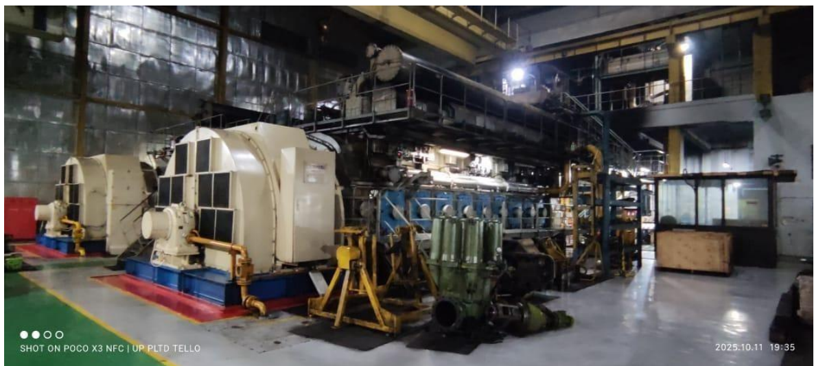
Gambar 2. 3 Pembangkit Listrik Tenaga Diesel Tello
