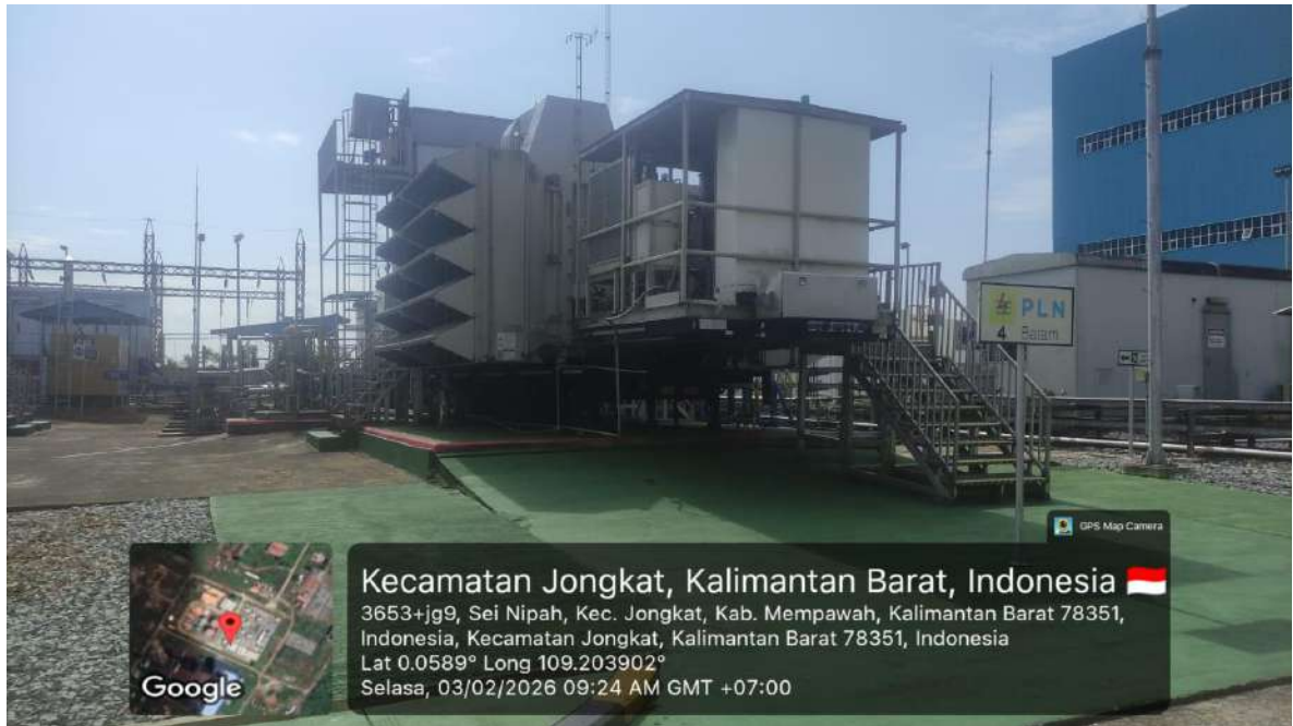
Gambar 2. 12 Pembangkit Listrik Tenaga Gas MPP Blok 2 Unit 4
