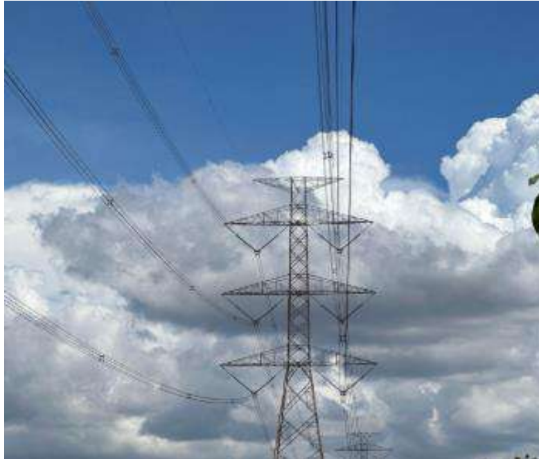
Gambar 2. 10 Saluran Transmisi Listrik
