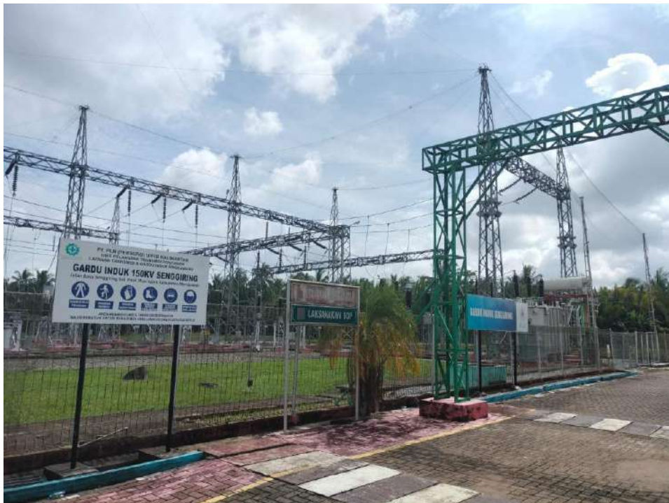
Gambar 2. 7 Gardu Induk 150 kV Senggiring
