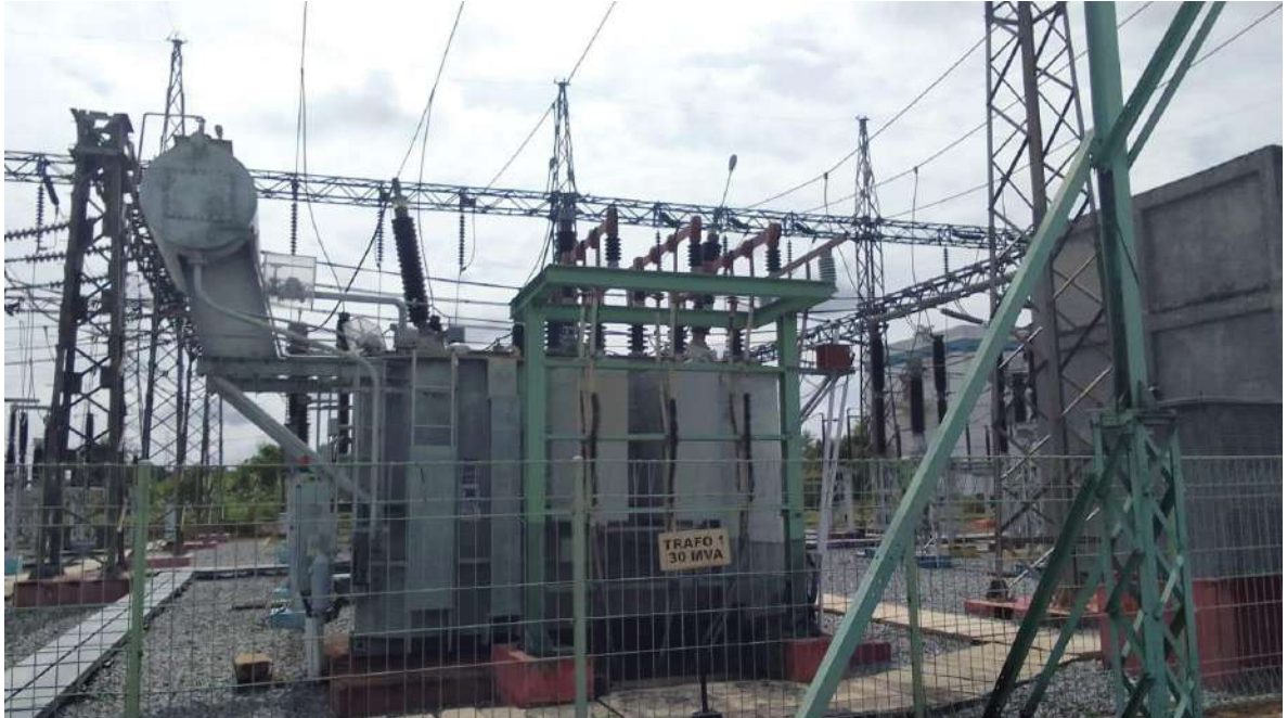
Gambar 2. 9 Transformator Daya 30 MVA GI Parit Baru
