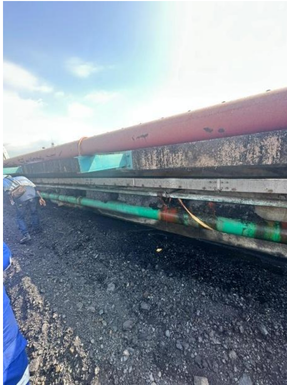
Gambar 1.1 Pipa Penanganan Debu Batubara Mengalami Kebocoran
