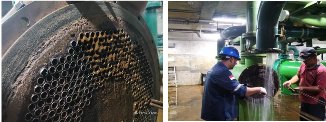
Gambar 1.2 kondisi Heat Exchanger yang mengalami penyumbatan akibat kotoran lumpur dan proses pemeliharaan/pembersihannya
