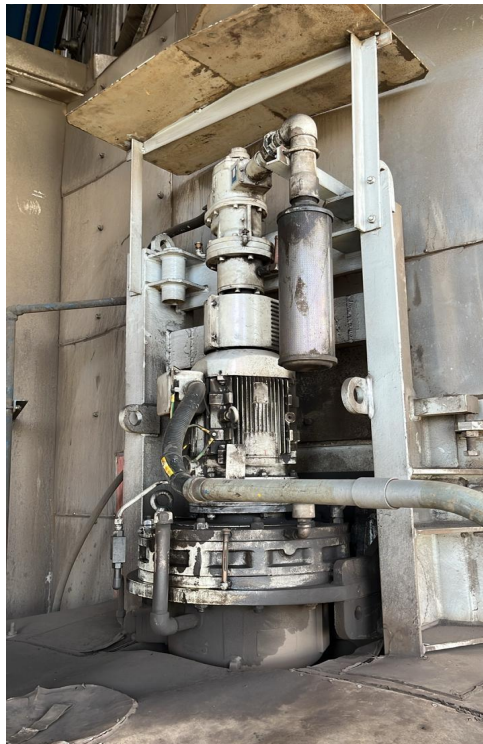
Gambar 2.21 Air Preheater (APH) motor (Sumber: Dokumen Pribadi )
