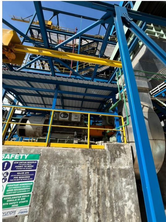
Gambar 2.20 Primary Air Fan
