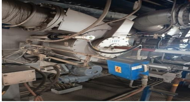
Gambar 2.13 Burner (Sumber: Dokumen Pribadi )
