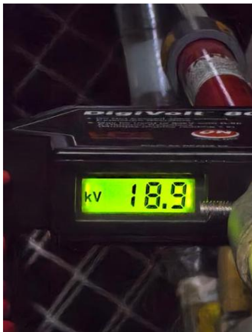
Gambar 1.2 Pengukuran tegangan layanan PT Juya Mining
