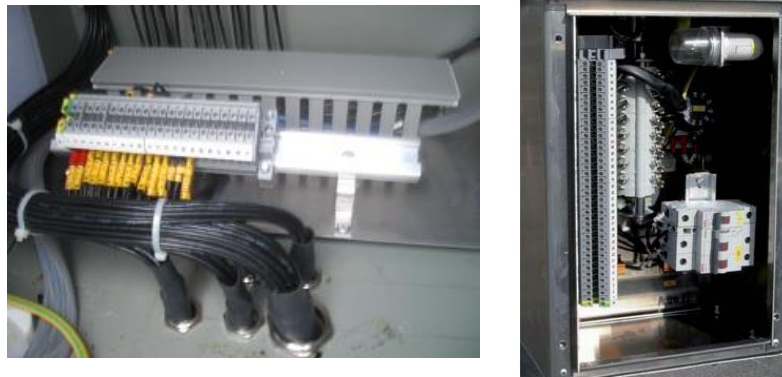
Gambar 2.15 Terminal dan Wiring control
