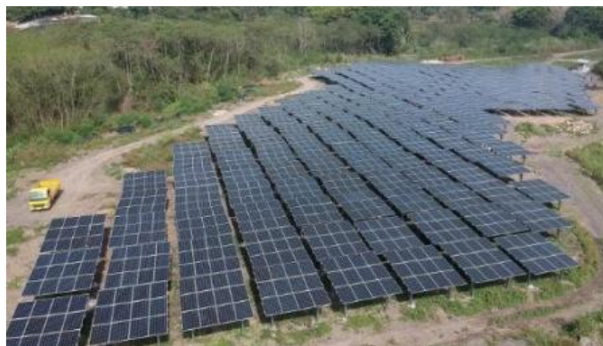
Gambar 2.1 Pembangkit Listrik Tenaga Surya
