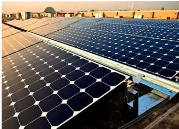
Gambar 2. 8 Pembangkit Listrik Tenaga Surya
