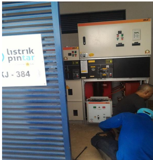
Gambar 2.2. Kubikel gardu beton
