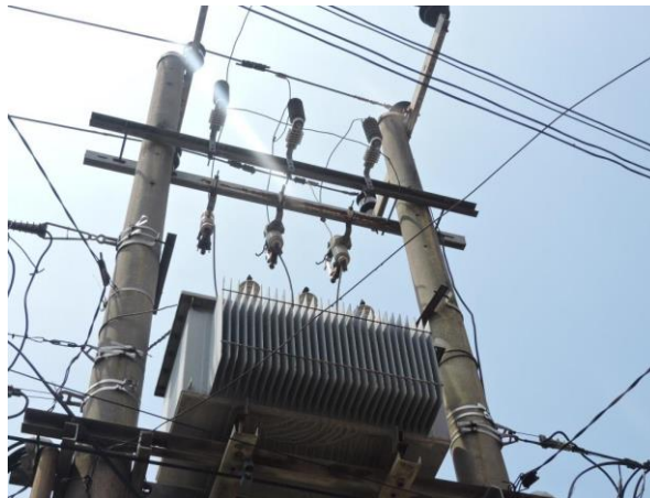
Gambar 2.4 Gardu portal tampak atas
