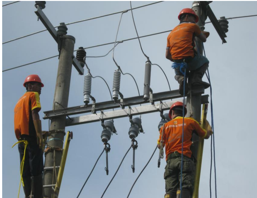
Gambar 4.1 Pemasangan lightning arrester trafo.
