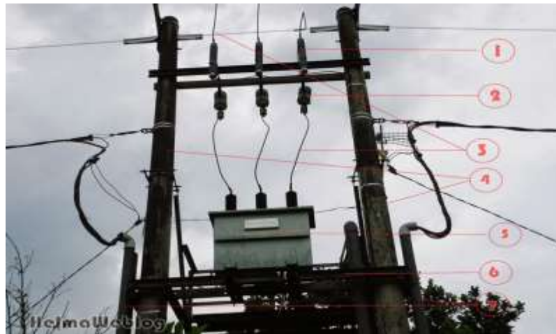
Gambar 2.4 Gardu portal tampak atas
