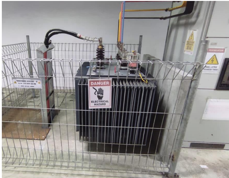
Gambar 2.3 Trafo UAT Sumber : (Dokumentasi PLTU Sofifi)
