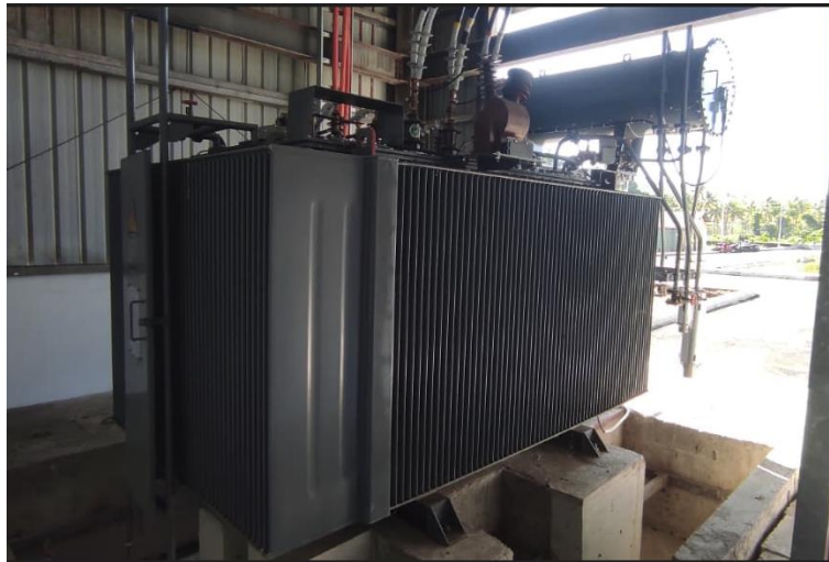
Gambar 2.2 Trafo GT Sumber : (Dokumentasi PLTU Sofifi)
