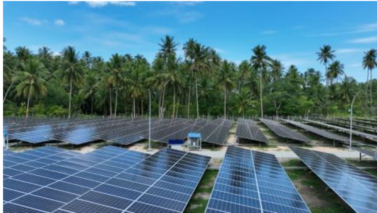
Gambar 2.1 Pembangkit Listrik Tenaga Surya (PLTS)
