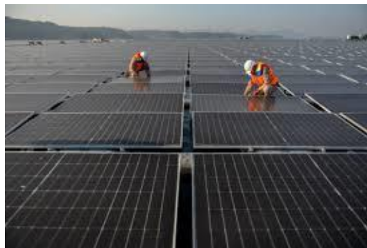
Gambar 2. 4 Pembangkit Listrik Tenaga Surya
