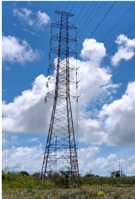
Gambar 2. 2 Tower tension (dokumentasi pribadi)
