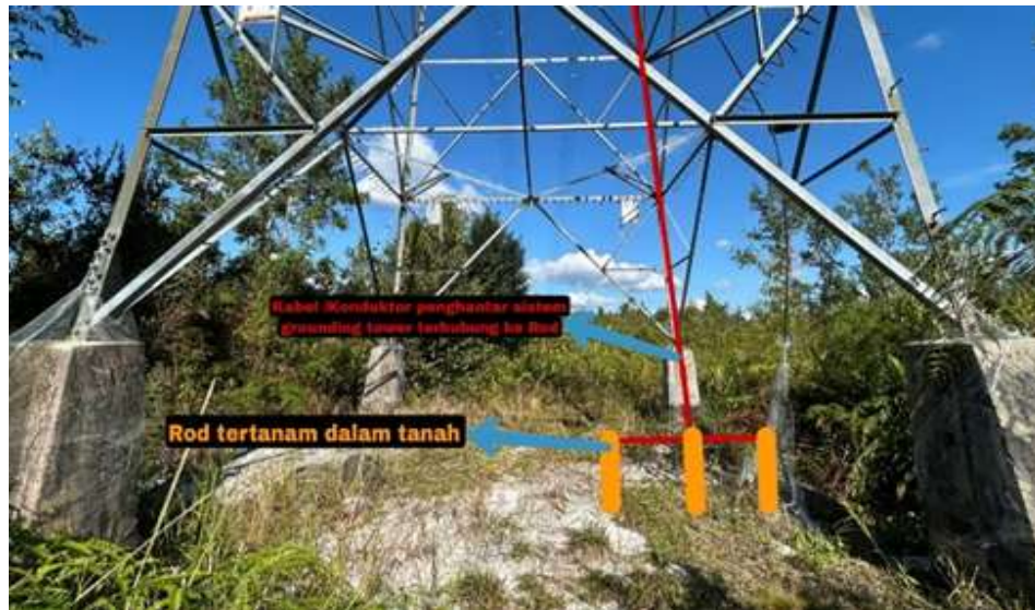
Gambar 2.1 Sistem Grounding pada Tower SUTT 150 kV
